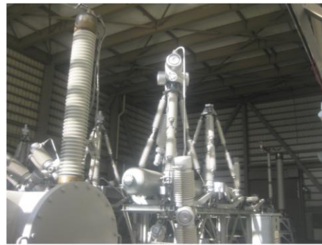
撮影：東京電力株式会社 H23.3.23
