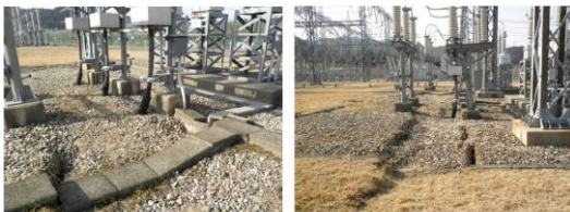
撮影：東京電力株式会社 H23.3.12
