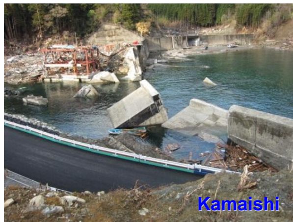
〔津波の洗掘による防潮堤の倒壊〕
