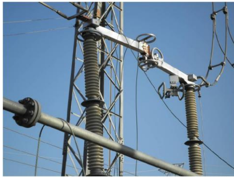
撮影：東京電力株式会社 H23.3.12
