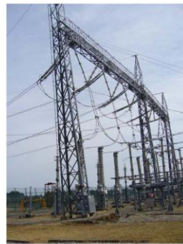
撮影：東京電力株式会社 H23.3.11
