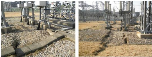
撮影：東京電力株式会社 H23.3.12
