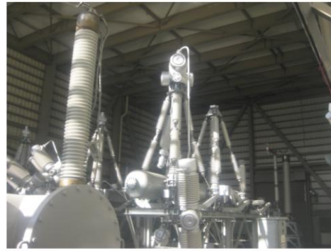
撮影：東京電力株式会社 H23.3.23
