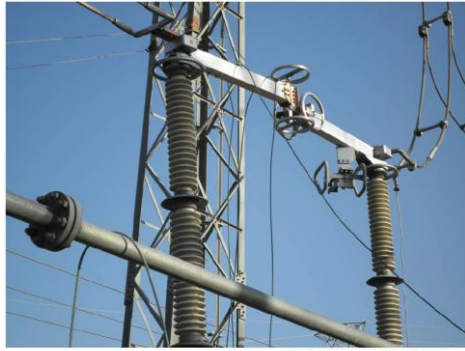
撮影：東京電力株式会社 H23.3.12
