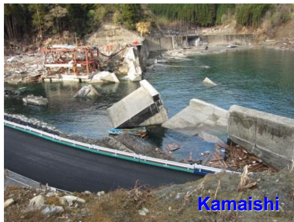
〔津波の洗掘による防潮堤の倒壊〕
