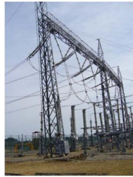
撮影：東京電力株式会社 H23.3.11
