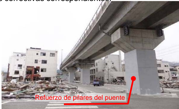
Estado del puente, luego del Gran Terremoto de Este de Japón (con medidas de refuerzo antisísmicos previamente aplicadas)
