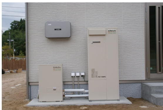
燃料電池発電設備であって出力10kW未満のもの
