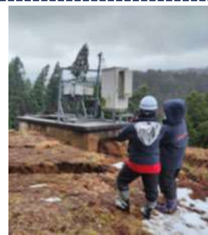
基地局の損壊
