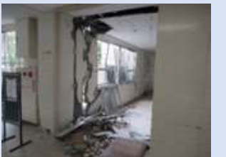
学校施設の被害
