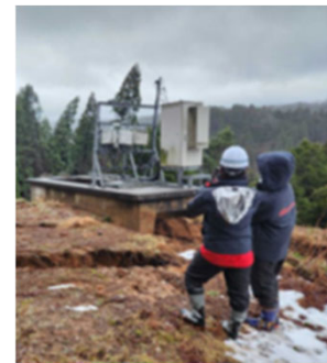
基地局の損壊
