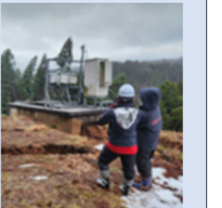
通信基地局の損壊
