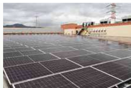
ホール経営の玉屋が2022年11月30日、玉屋筑前店屋上を利用した太陽光発電システムの運用を開始
