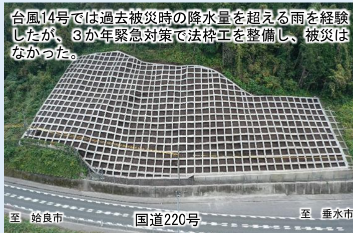
<国道220号（鹿児島県垂水市）降雨状況>
