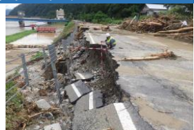
⑬国道113号の被害状況 (新潟県村上市)
