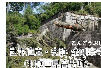
【被災例】台風第7号による倒木 徳川家臺台周囲の玉垣等が棄損
