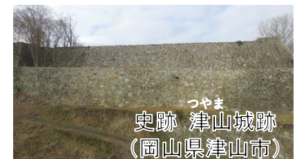
【対策例】排水対策を含む二の丸東側石垣の老朽化対策を実施
