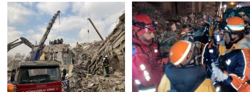
トルコ地震による被害状況（JICA提供）
