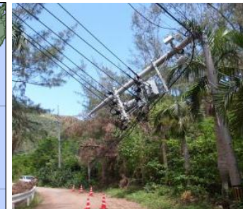
台風第6号による被害の様子 (沖縄県渡嘉敷村)
