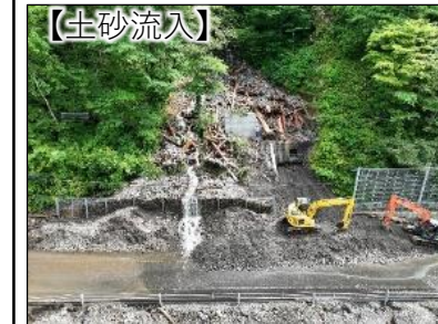
未対策箇所での被災事例 （国道274号（北海道日高町～清水町間）の令和4年8月の大雨による土砂流入）
