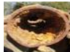
管路の老朽化が進行
