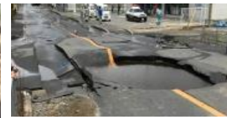
地震による管路の被災状況
