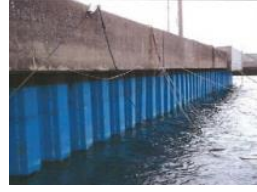
岸壁、鋼製矢板の腐食対策
