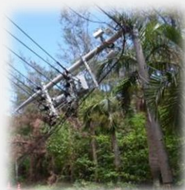
電柱破損の様子（渡嘉敷村）
