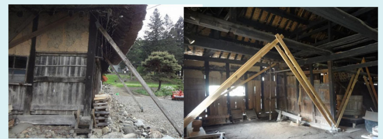
ほおのきだてけ 重要文化財 旧朴館家住宅（岩手県） 本格修理に着手できず、倒壊防止のため、仮設の筋交いを設置
