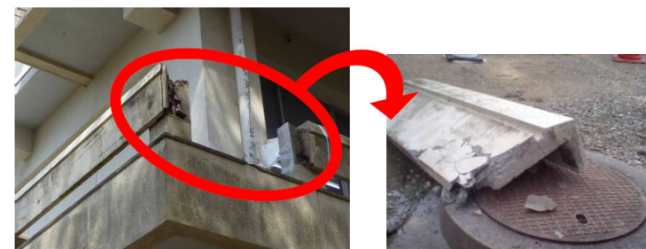
老朽化により手すりが落下
