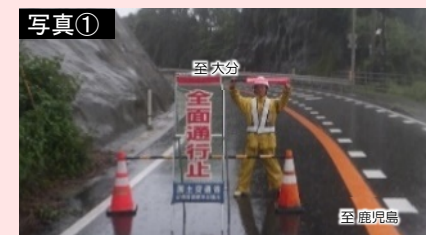
▲写真① 国道220号における規制(伊比井地区) (令和5年7月3日～4日)
