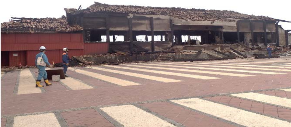
②北殿（建物南側から撮影）（全焼）
