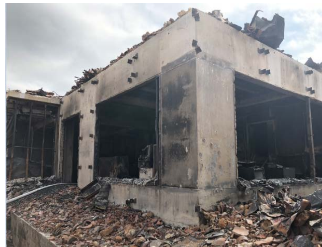
⑥二階御殿（建物西側から撮影）（全焼）
