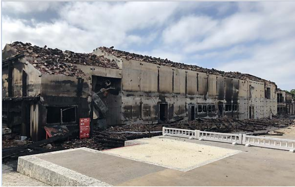
④黄金御殿（建物北側から撮影）（全焼）
